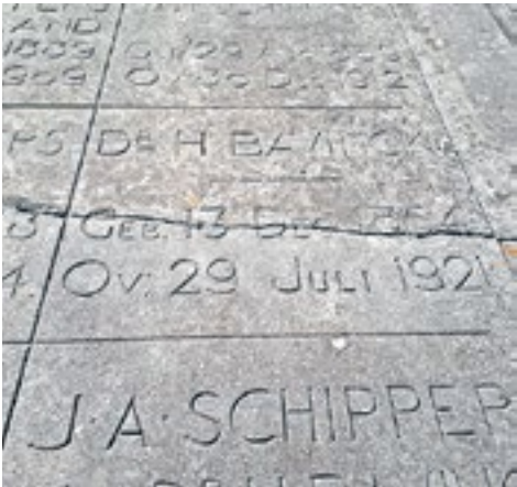
De barst in de kleine gedenksteen op de betonplaat.
